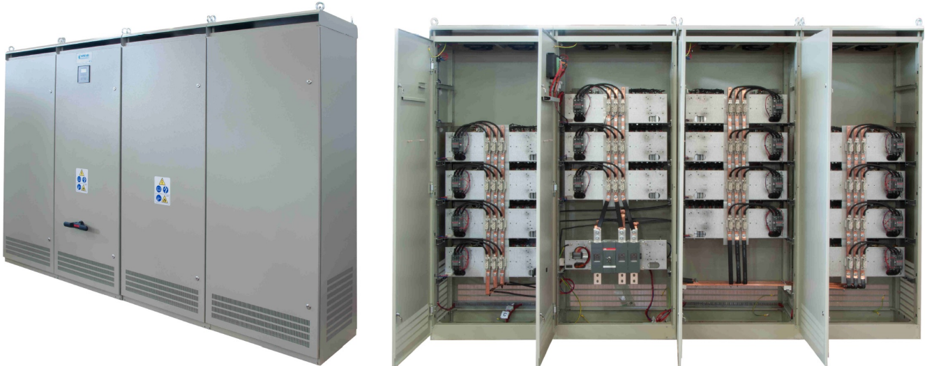
Foto dell'apparecchiatura AAR/D20 1150kVAr installata.
